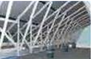
太陽光発電電架台
