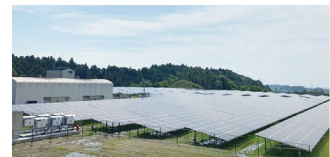
茨城県高萩市の太陽光発電設備
