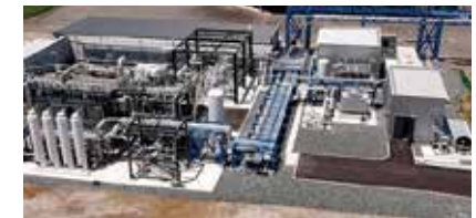
知多緑浜工場の水素製造プラント(2024年6月運転開始)
