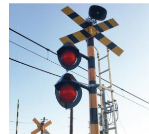
全方位警報灯の整備
