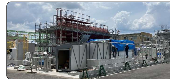
アンモニア供給設備（5月末完工予定）
