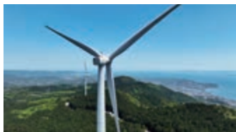
JRE大分別府湾風力発電所
