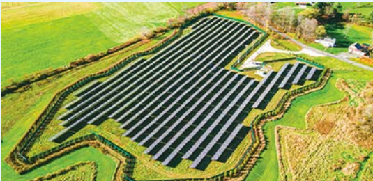
Nexamp 社の分散型太陽光発電設備
