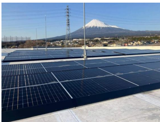
設置した太陽光発電設備（一部）
