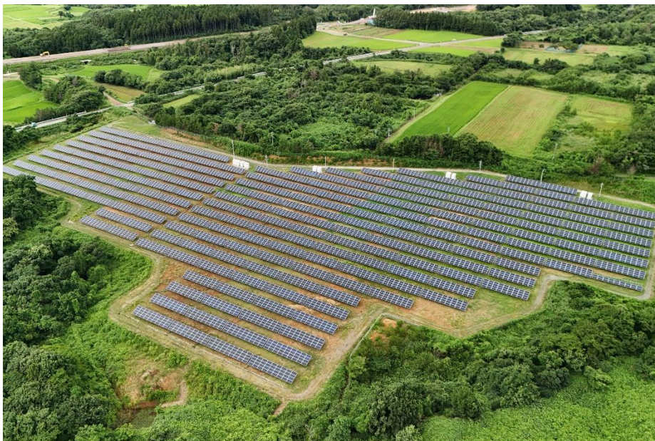
設置場所：にかほ市象潟太陽光発電所
