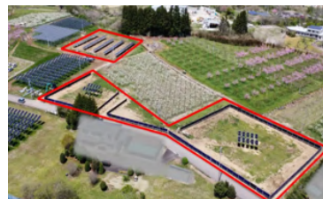
営農型オフサイトPPAにおける太陽光発電所（福島県福島市）
