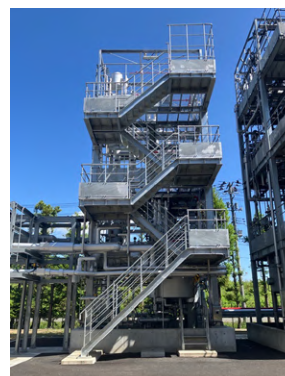
溶剤のクローズドリサイクルが行われている施設(廃溶剤処理設備)
