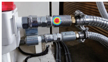
エア漏れの可視化
