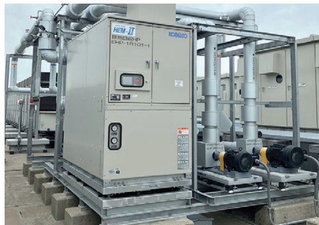
関東工場のヒートポンプ設備
