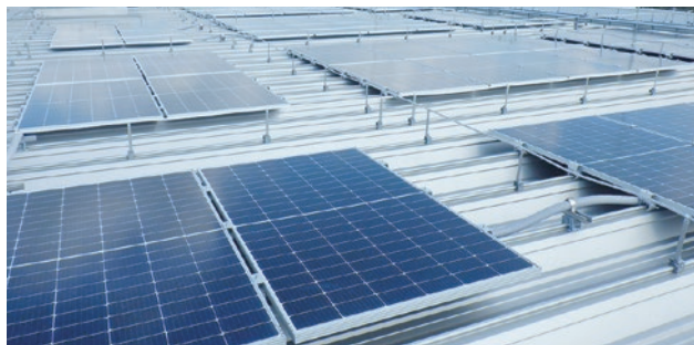
太陽光発電設備
