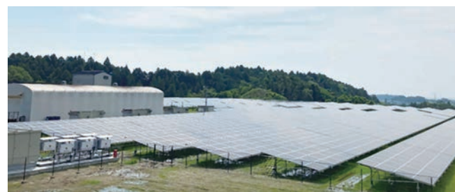
茨城県高萩市の太陽光発電設備
